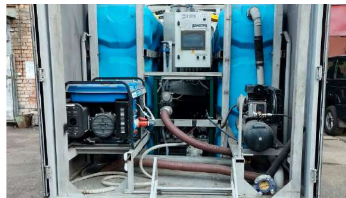
*Растворный узел с ёмкостями для чистой воды
